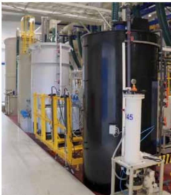
Obr. 6: Rezervní a přípravné nádrže, dávkování
