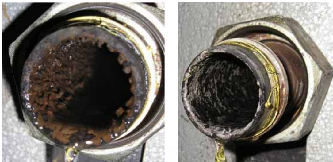
Obr. 2 Vnitřní povrchy potrubí teplosměnné soustavy před a po čištění
