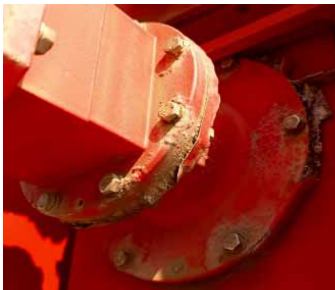
Obr. 17: Stav EP+PUR lakované Al příruby po 1 roku v prostředí oceánu
